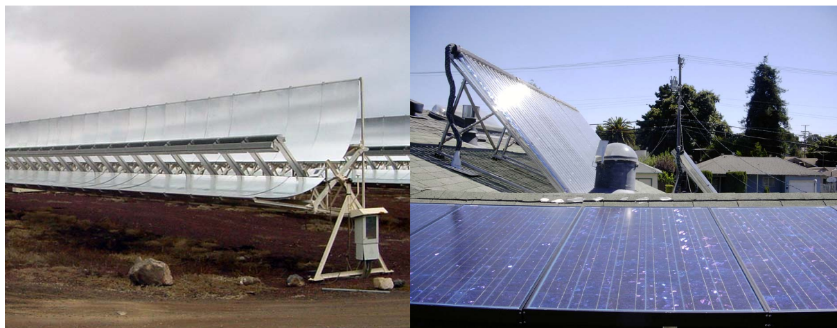
Figura 3.1. Instal·lacions d'energia solar tèrmica
