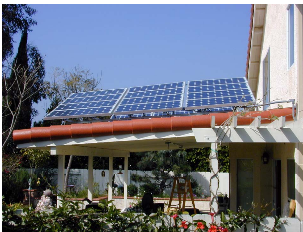
Figura 3.2. Instal·lació solar fotovoltaica
